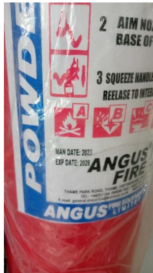
Photo : Extincteur avec date de validité à jour disposé dans le centre
