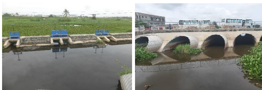
Planche 2 : Dispositif des batardeaux et des buses alimentant le canal de drainage à Vossa
