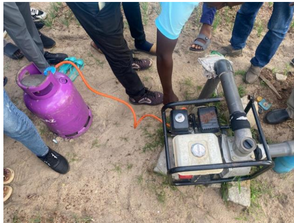
Photo 3 : Motopompe connecté au gaz domestique
