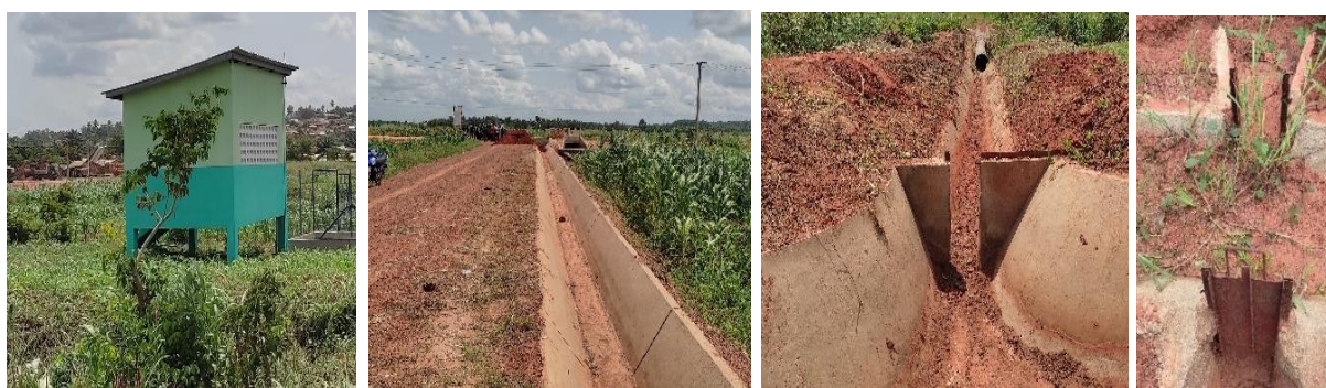
Planche 4 : Station de pompage d'eau, canal principal, pertuis à batardeaux, partiteurs et canaux secondaires sur le site des travaux d'aménagement hydro agricole à Agonlin Lowé à Azowlissè Source : ALOFA, mai 2024
